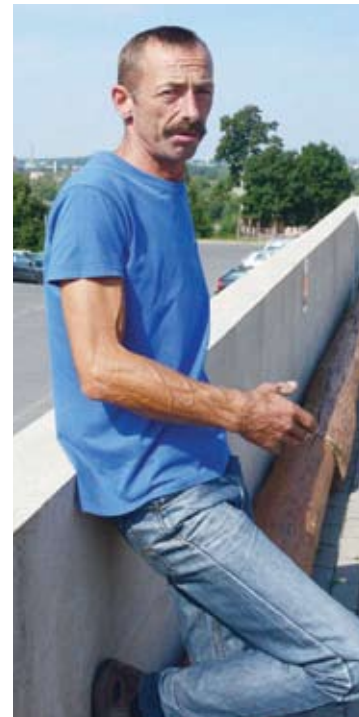
Laikinis sporto ir pramogų centro „Kalita“ vadovas Romas Savickas teigia, kad ant pastato atsivėrę defektai Kalitos kalno lankytojams pavojaus nekelia.
