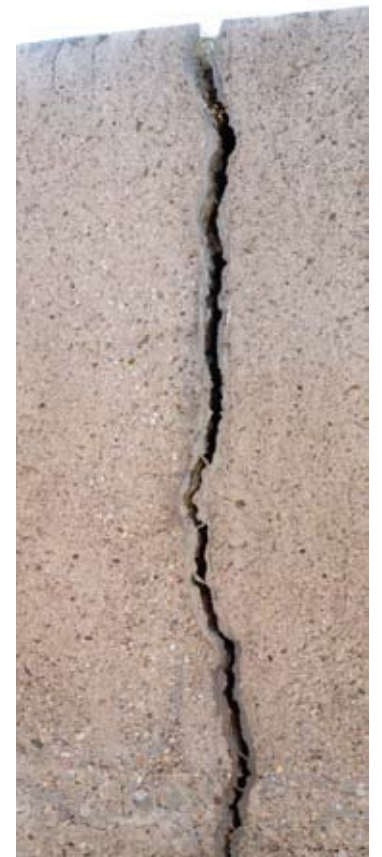
Kalitos turizmo centro pastato sienos ėmė skilinėti tuoj pat po pastato pridavimo Valstybinei statybos komisijai.
